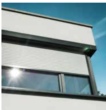
Vorbaurollladen QUADRO flächenbündig mit der Fassade montiert.
